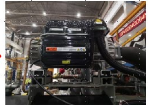
壓縮機外觀與銘牌檢查
