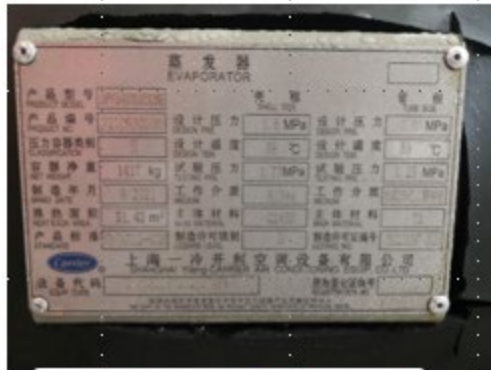
蒸發器與冷凝器外觀 與銘牌檢查
