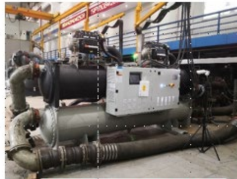
冰水機外觀與銘牌檢查
