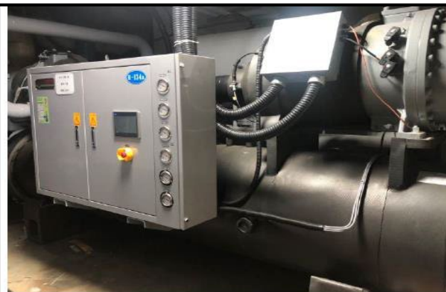
冰水機外觀照片
