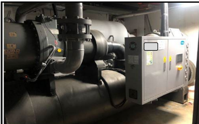
冰水機外觀照片（含銘牌及能源標示）
