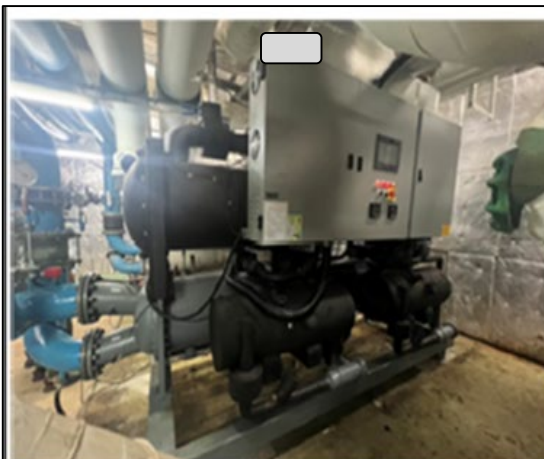
冰水機外觀照片（含銘牌及能源標示）
