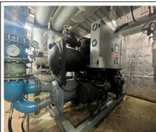
冰水機外觀照片
